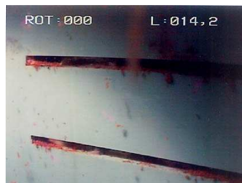
Photo4 : vue des crépines propres après nettoyage
