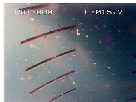
Photo5 : vue des crépines propres après nettoyage
